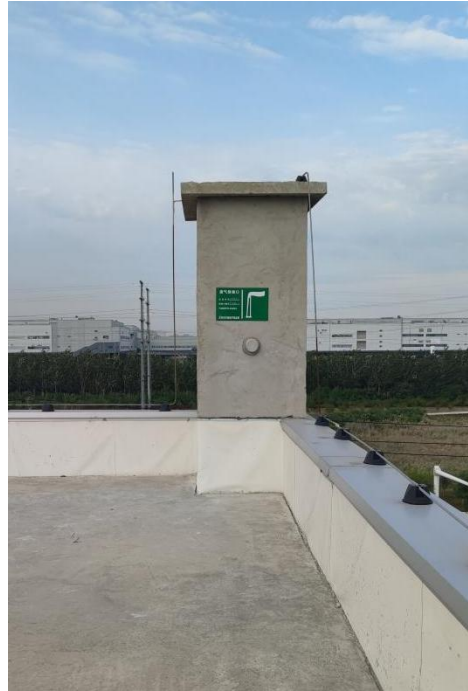
P WWTC 排气筒及标识牌
