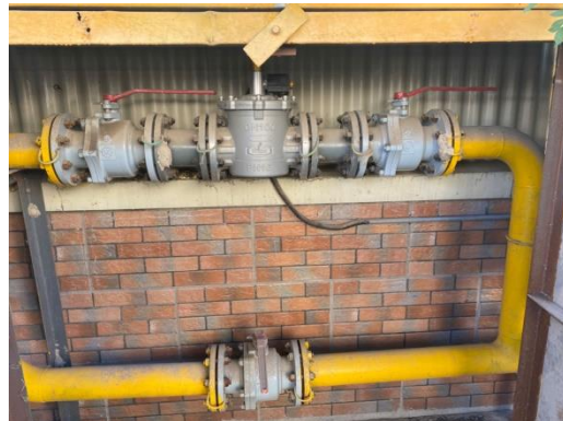
锅炉房-自动切断阀+手动切断阀
