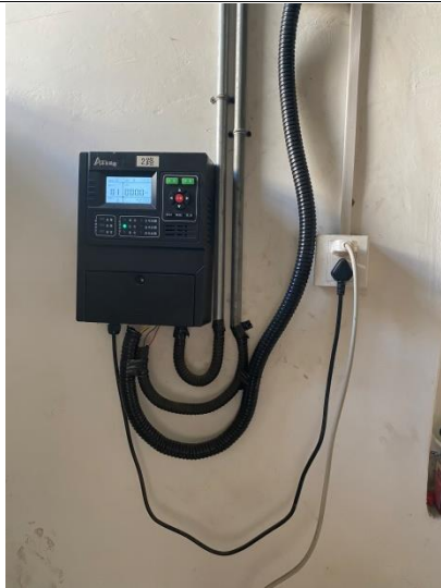
锅炉房-可燃气体报警器
