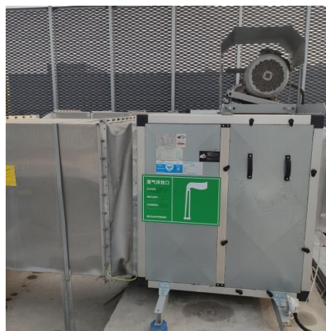
DA001 排气筒标识牌
