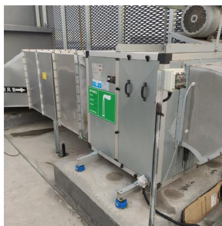
DA002 排气筒标识牌
