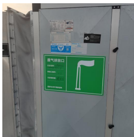
DA003 排气筒标识牌
