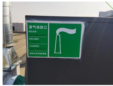
废气排放口标识牌
