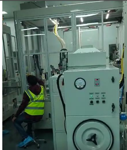
电池环缝焊接系统
