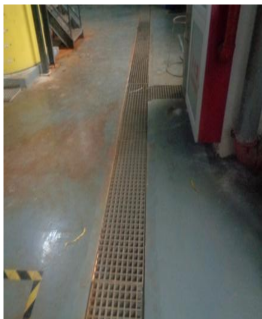
污水处理站内边沟
