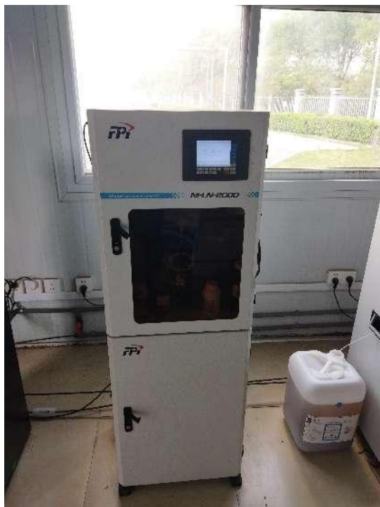
氨氮在线监测设施
