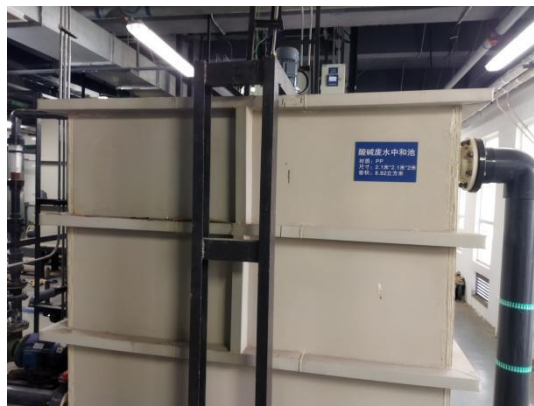
酸碱废水中和池
