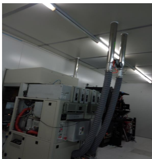
化学气相沉积集气管道
