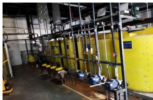
废水站配药罐
