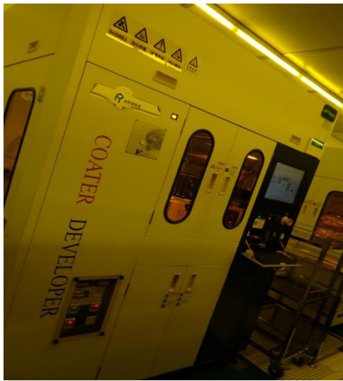
光刻显影工序集气管道
