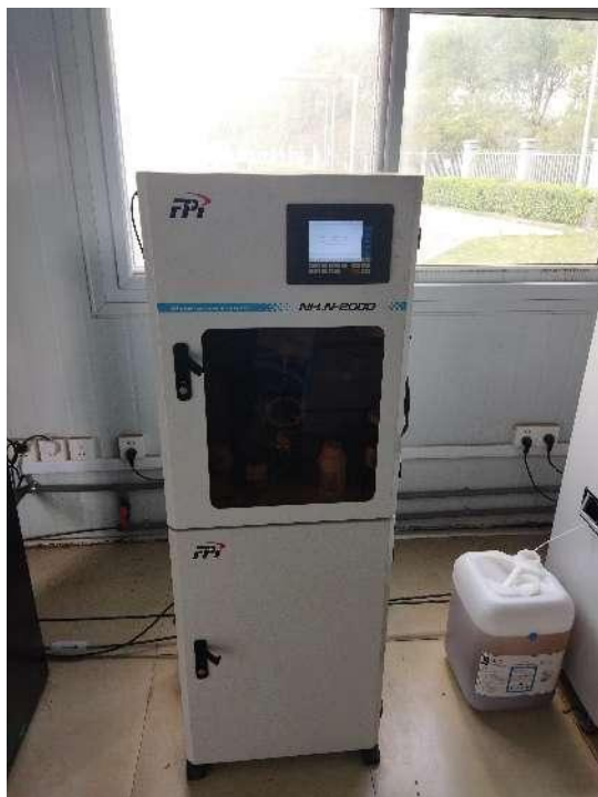
氨氮在线监测设施
