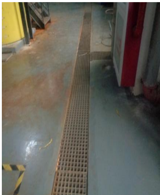
污水处理站内边沟
