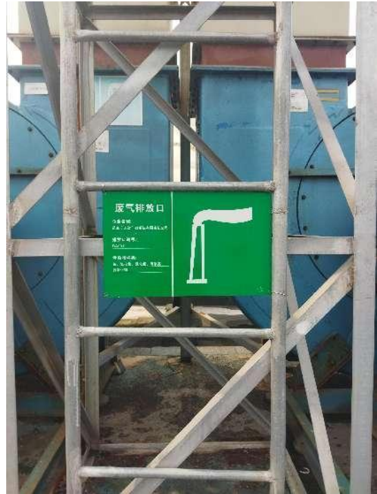
排气筒 DA001 标识牌
