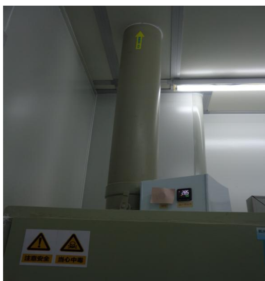
清洗工序集气管道
