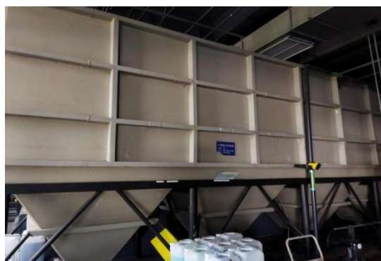
含氟污水处理系统
