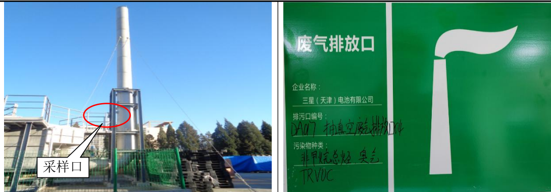
抽真空废气排气筒 DA017 及规范化
