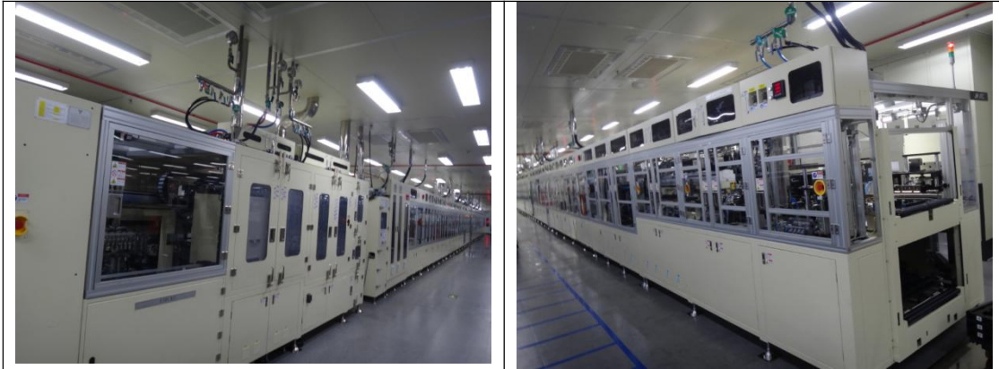
现有组立设备透明隔板封闭设施照片
