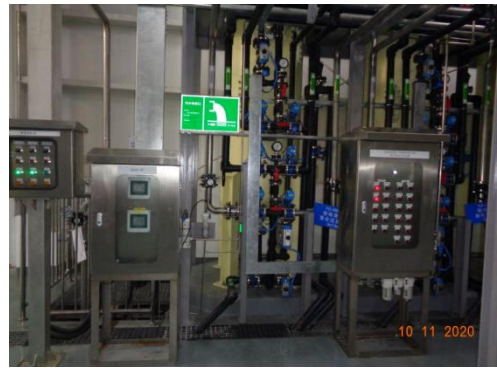
重金属废水前处理设施出水口
