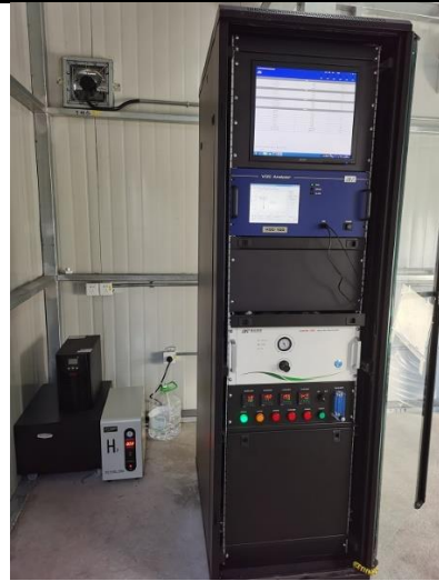
有机废气在线监测设施
