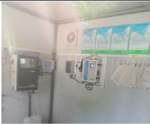
在线监测房间室内设备
