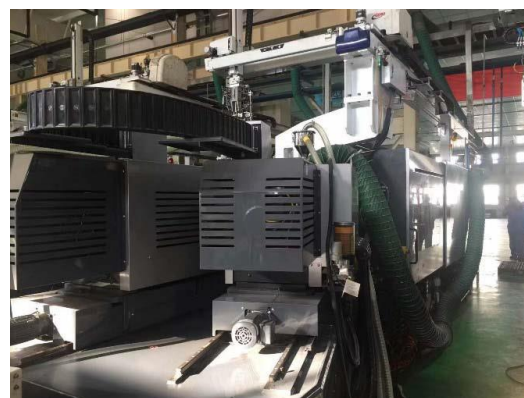
注塑废气集气管道设置
