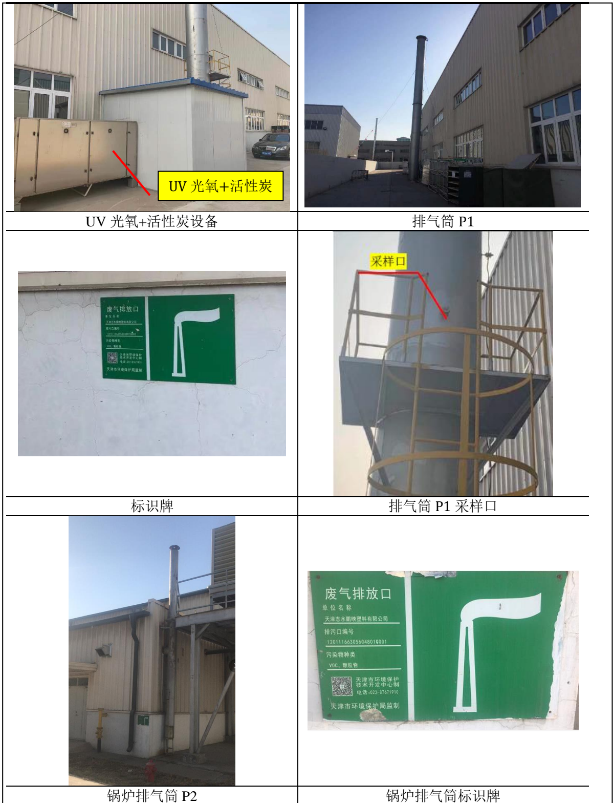
图 1-5 废气排气筒规范化
