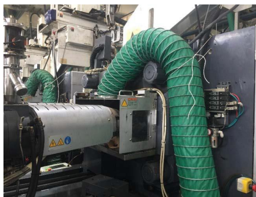
注塑废气集气口设置
