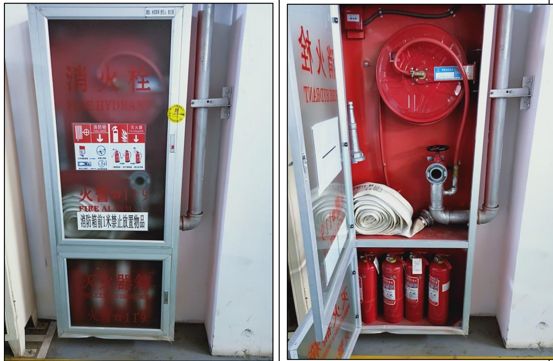
应急消防设备
